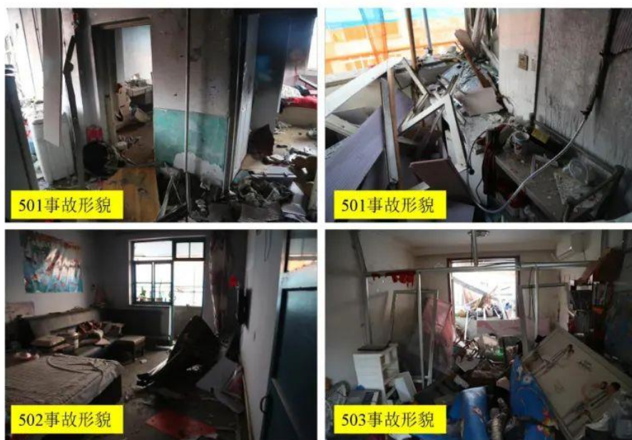
图 8 501 室、502 室、503 室破坏形貌
