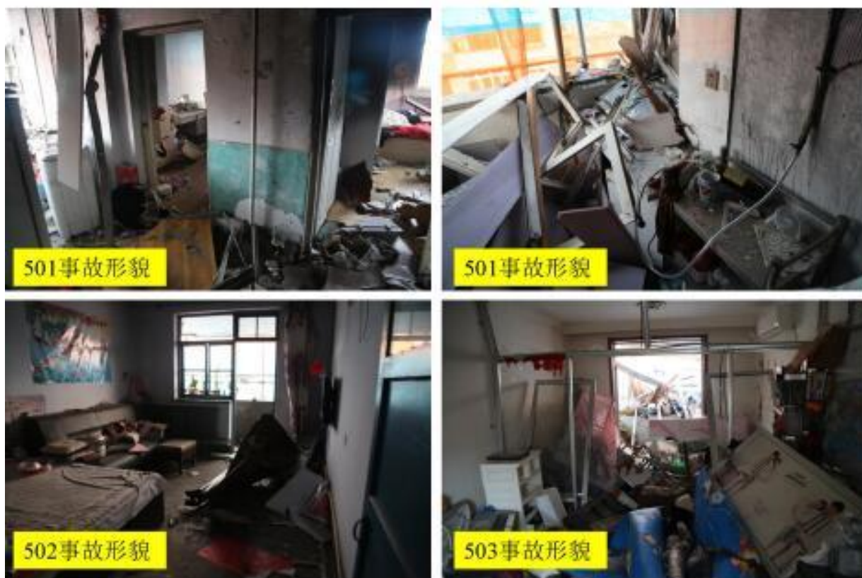
图 8 501 室、502 室、503 室破坏形貌
