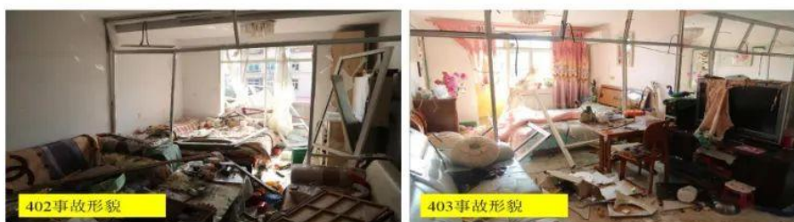
图 11 402 室、403 室破坏形貌
